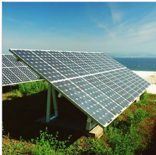
Instalação solar fotovoltaica isolada
