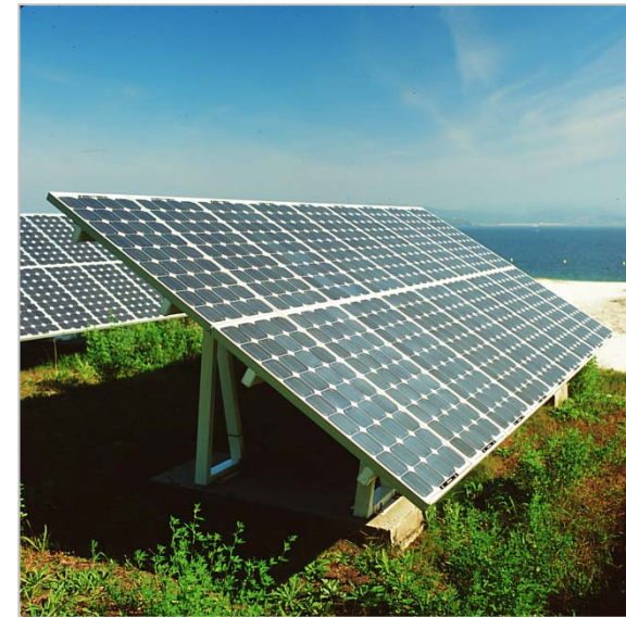
Instalación solar fotovoltaica aislada
