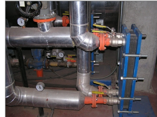
Sistemas de tubos e intercambiador de calor num sistema de AQS
