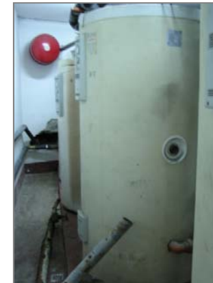
Depósitos acumuladores de ACS
