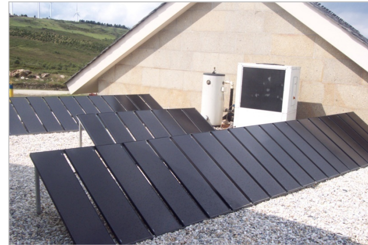
Instalação solar térmica
