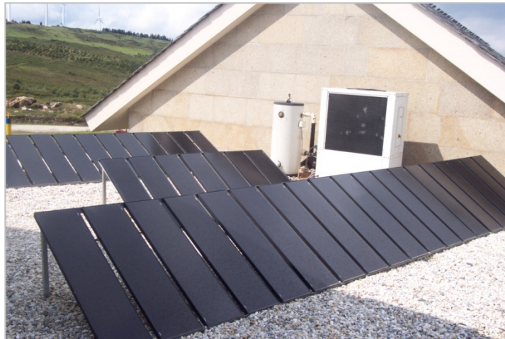
Instalación solar térmica
