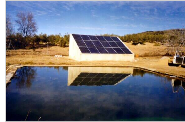
Instalação solar fotovoltaica para sistema de bombagem
