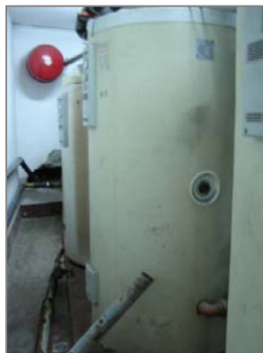
Depósitos acumuladores de AQS
