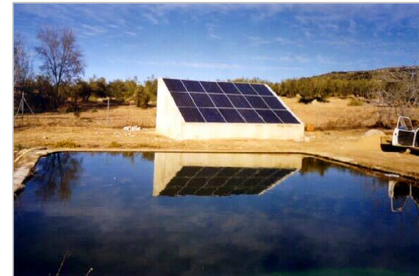
Instalación solar fotovoltaica para sistema de bombeo
