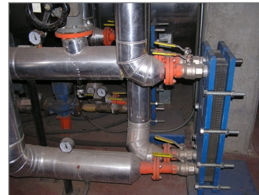
Sistemas de tubos e intercambiador de calor en un sistema de ACS
